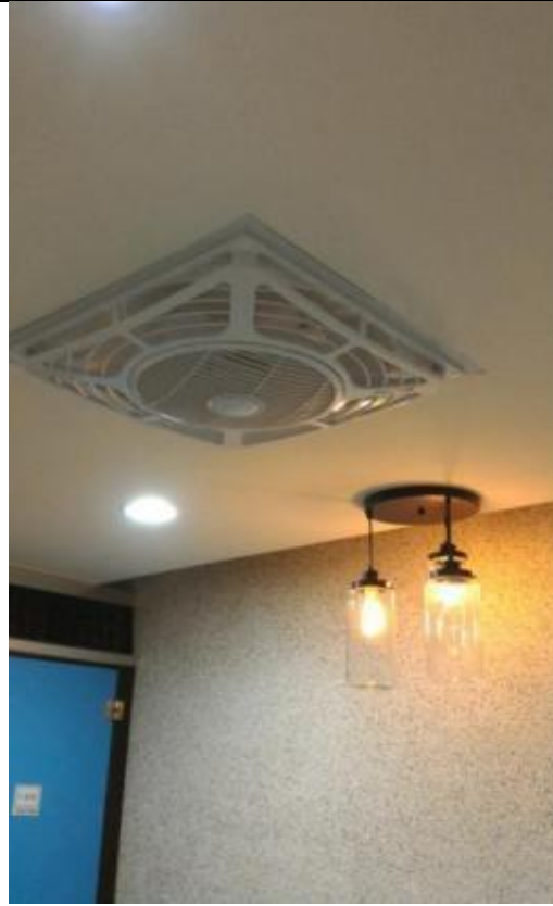
圖 13-5 廁所內採機械換氣，減少廁所臭味。(來源：張志源拍攝)
